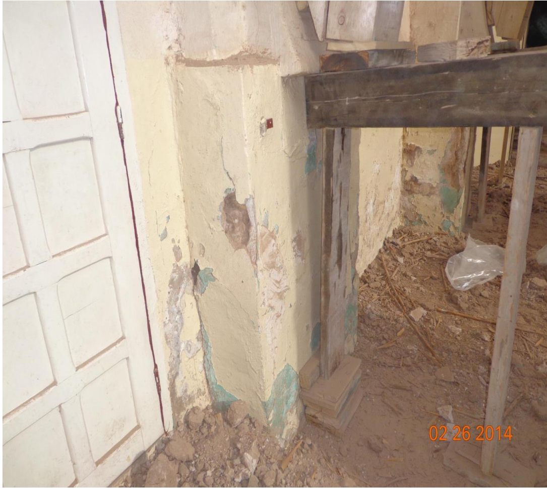
الصورة رقم 11: تأثير الرطوبة وتساقط الجدران قبل عملية الترميم
