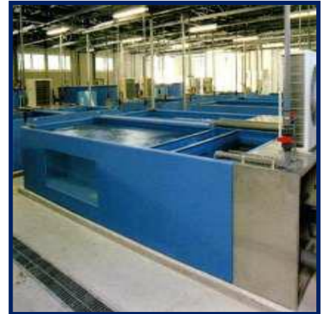
Figure 130: Salle de filtration de l'eau
