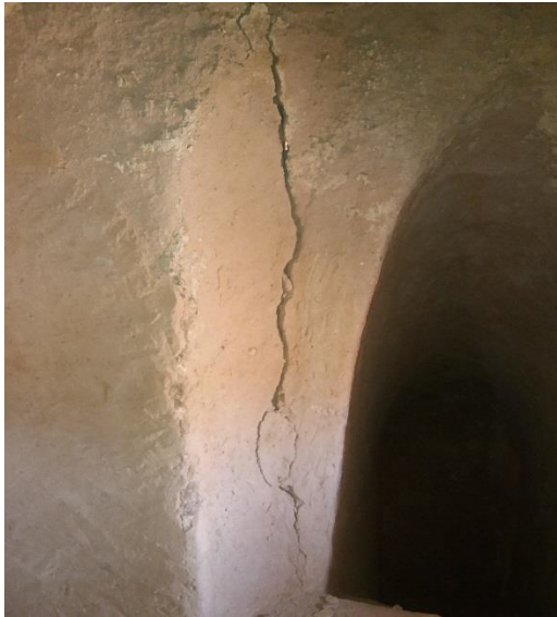
الصورة رقم 74 : التشققات التي تصيب برج الخوخة من عمل الطالب
