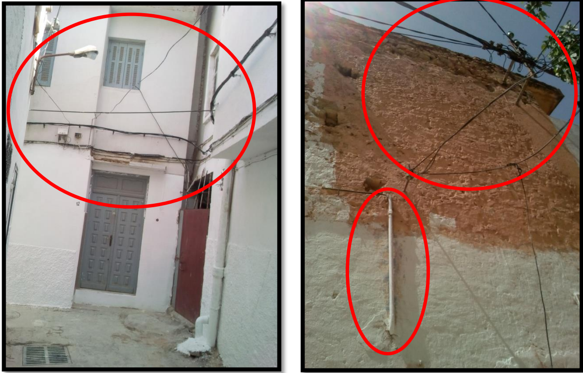
الصورة رقم 07: تشوه المظهر الخارجي للمباني
