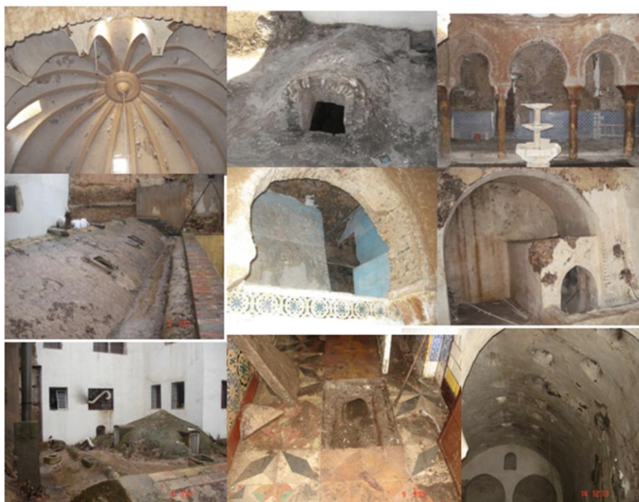
Fig.74. Hammam E'ssabaghine -bain des teinturiers- (période Almoravide) pendant sa restauration Source: OGEBC 373
