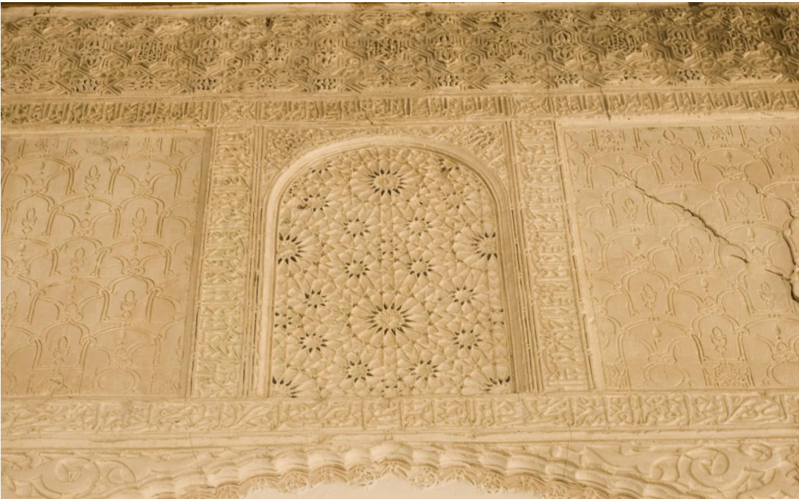
الصورة رقم 12: مسجد سيدي أبي الحسن التنسي، الجدران
