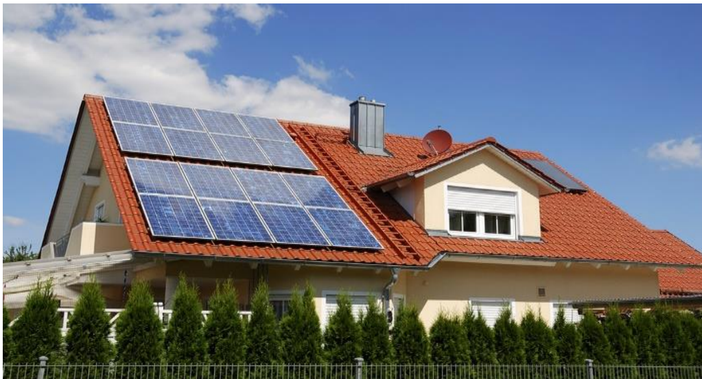
Figure 1. 36 : panneaux solaires photovoltaïques [3]
