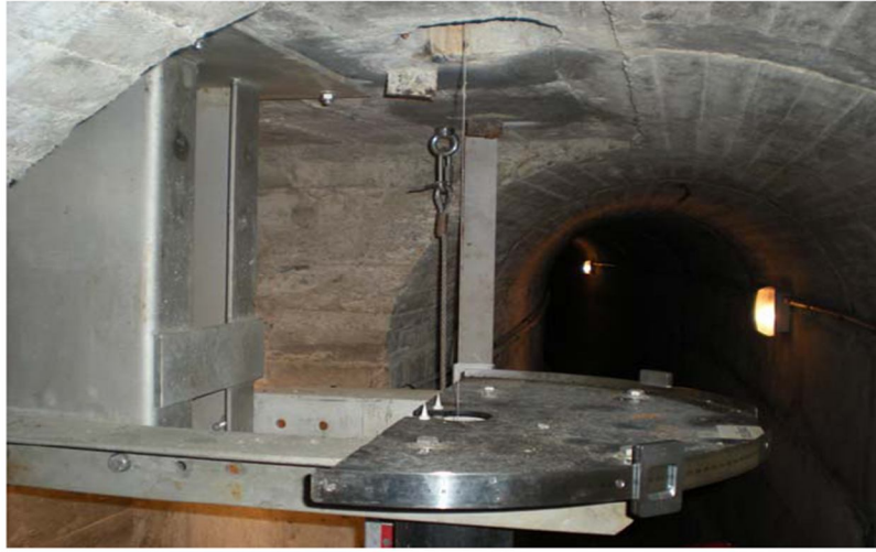
Figure II.11 : Installation d'un pendule avec table de lecture dans une galerie de barrage (EDF et Cemagref, 1998)
