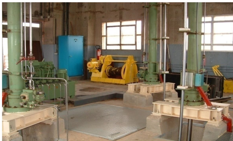
Figure II.35 : Equipements hydromécaniques concernés par les essais périodiques, barrage
