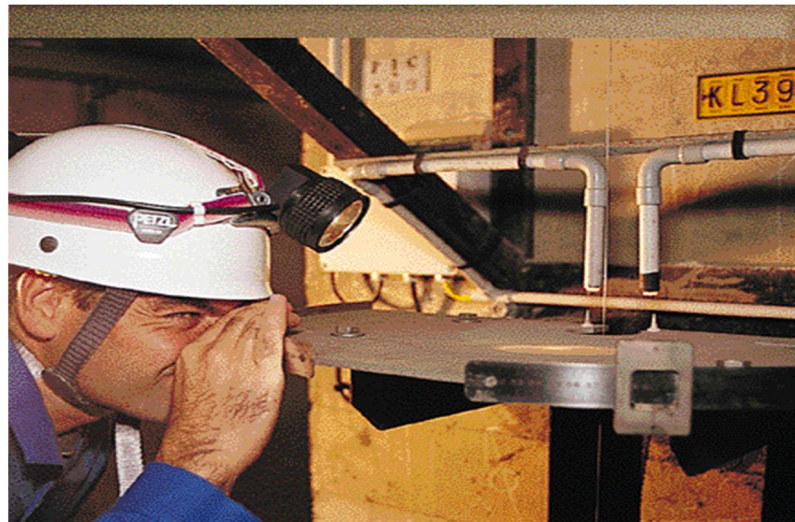
Figure II.12 : Pendule, table de lecture des déplacements horizontaux (EDF et Cemagref 1998)
