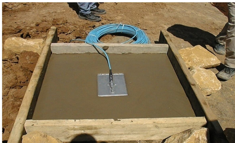
Figure II.33 : Installation d'une cellule de mesure de pression totale au niveau des remblais d'un barrage (Smail, 2007).
