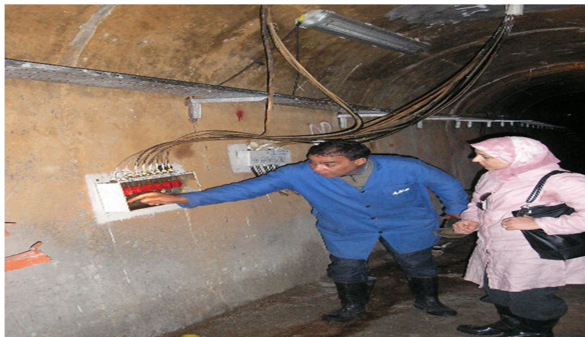
Figure II.30 : Mesure de pression interstitielle par capteur électrique dans la galerie de visite du barrage Sidi Abdelli, Wilaya de Tlemcen (Smail, 2007)
