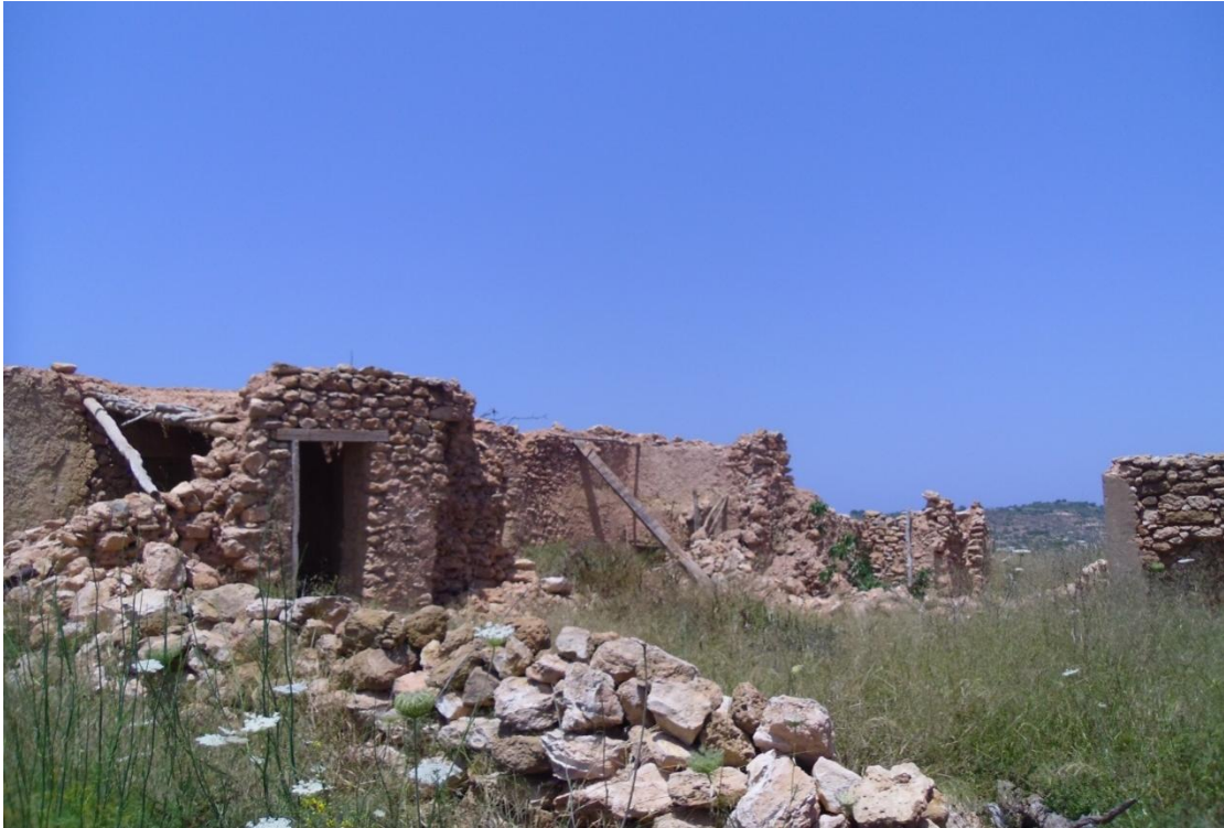
Photo 35 : L'intérieur de la maison : dans un état de dégradation très avancé, notamment le côté nord, le plus ancien Source : Auteur
