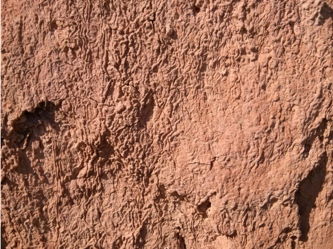
Photo 30 : Enduit utilisé à base de terre et de la paille Source: Auteur
