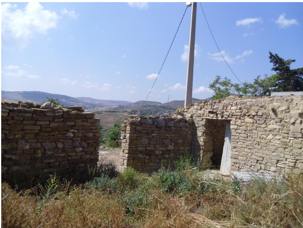
Photo 49 : Intérieure de la maison dans un état de dégradation avancé Source: Auteur
