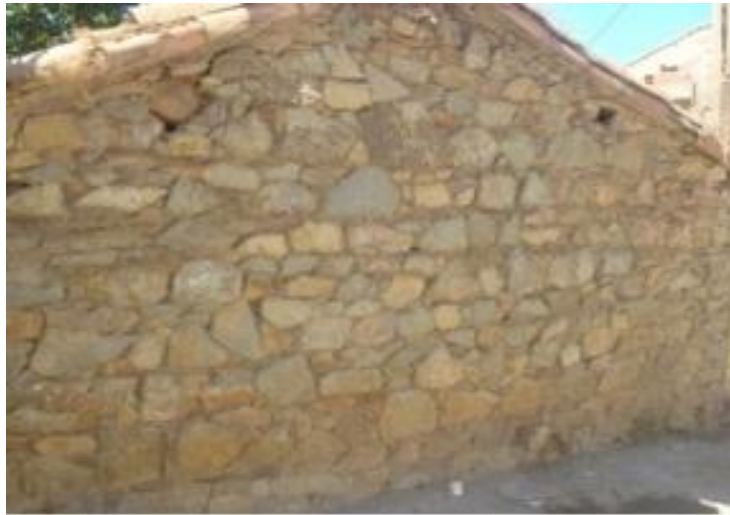
Photo 9 : Construction en pierre liées au mortier. village Tagmount Azouz, Tizi-Ouzou Source : Alili Sonia, mémoire de magistère, 2003.
