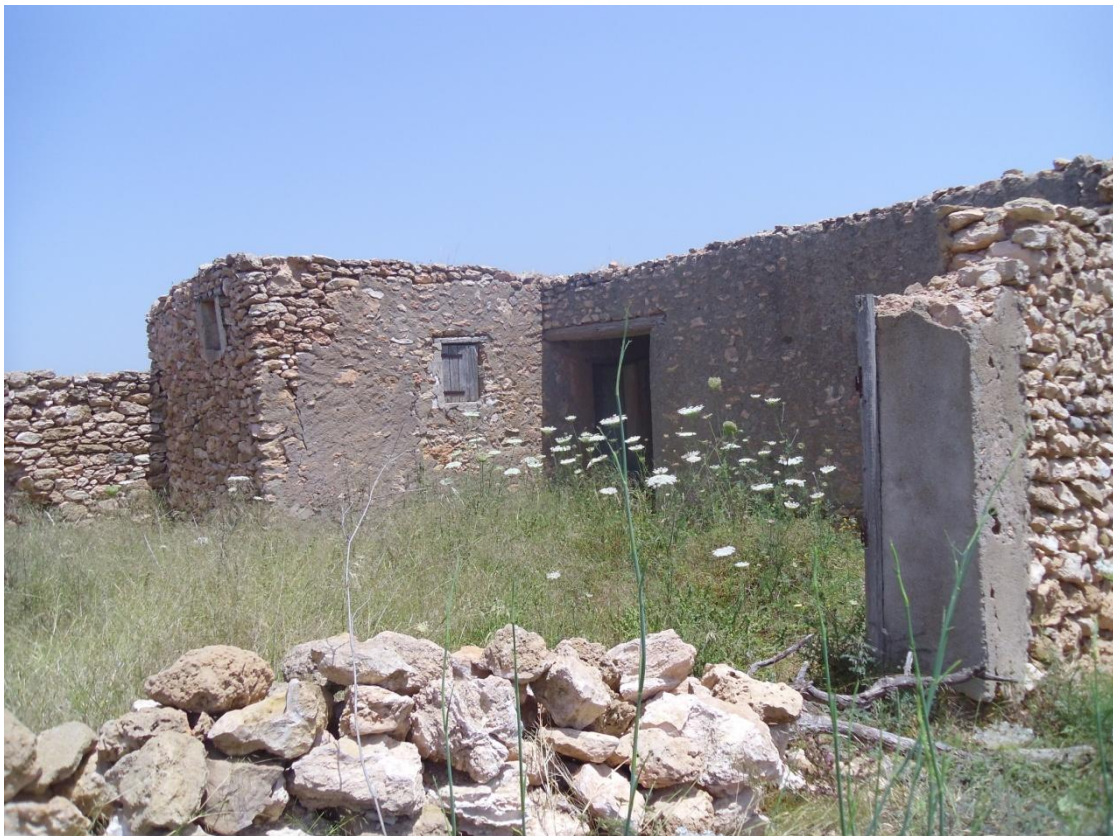
Photo 36 : Vue générale du côté sud de la maison relativement moins dégradé Source : Auteur
