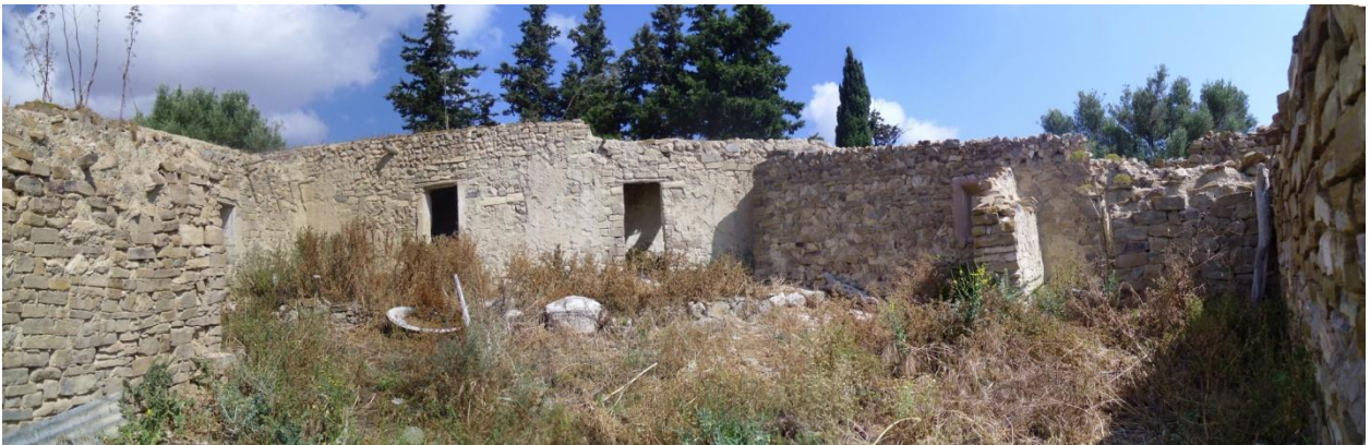
Photo 47 : Intérieur de la maison abandonnée dans un état de dégradation Source: Auteur
