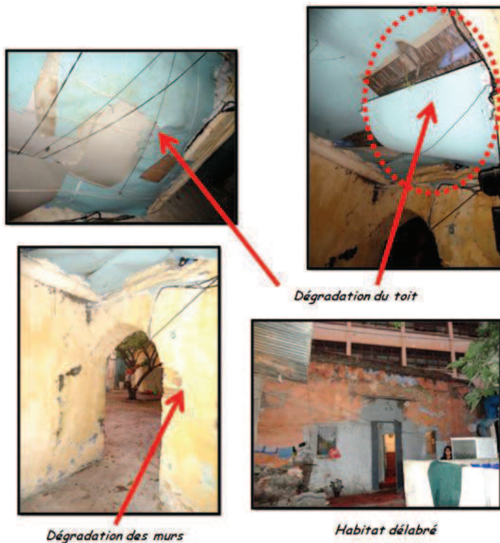
Fig.113: l'état de dégradation des anciennes maisons Source: auteur -2011
