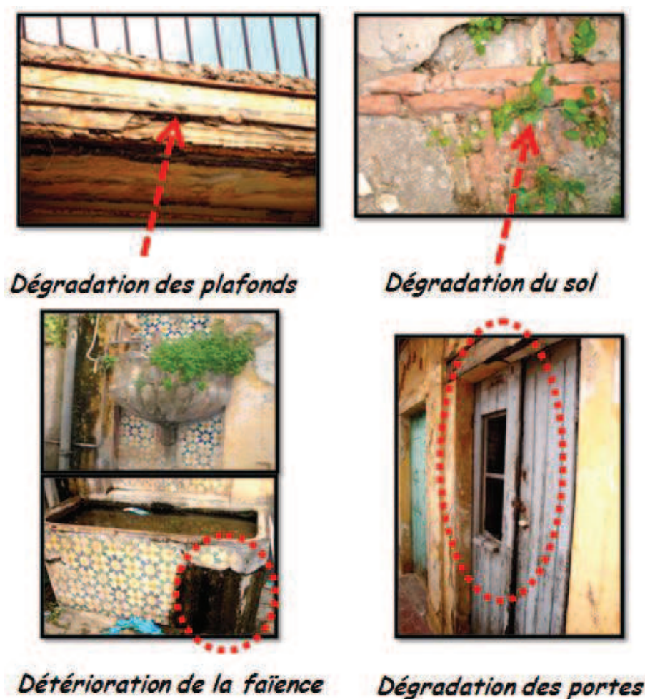
Fig.88: dégradation des bâtisses au niveau d'El Kissaria Source: auteur
