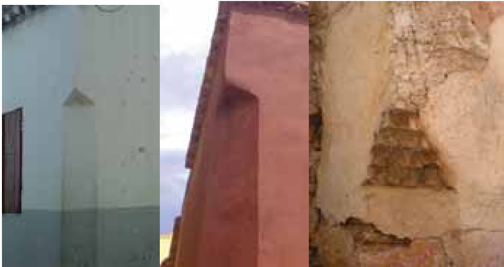
Figure 61 : À gauche et au centre, Pans-coupés avec arrêt en biseau à Tlemcen ; à droite, Pans-coupés dégarnis de leurs enduits à Tlemcen.
