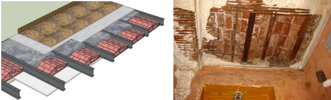
Figure 69. Toiture/plancher en voutains (Source: la photo à droite est prise par l'Auteur et le détail technique est pris depuis Apur 2011).
