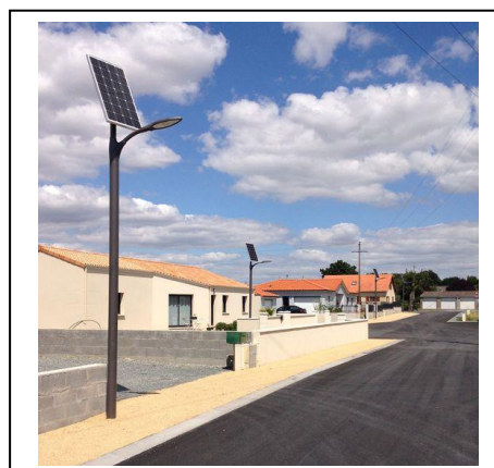
Lampe d'aire a énergie solaire
