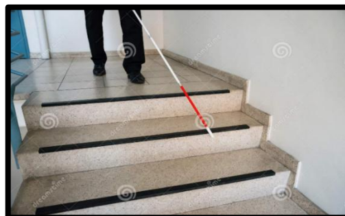
Figure 31 : escalier adapté à non voyant
