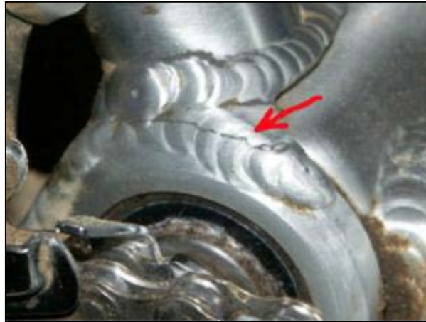
Figure II-01: Exemples de fissures sur aluminium. [10]
