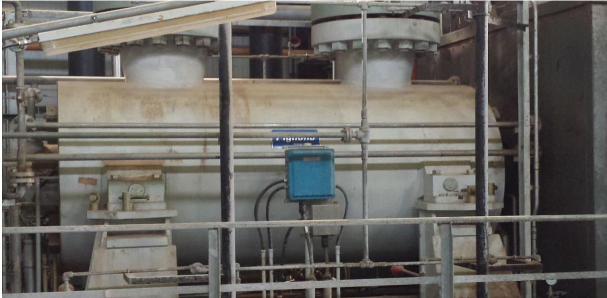
Figure.III.3.Corps du compresseur BCL
