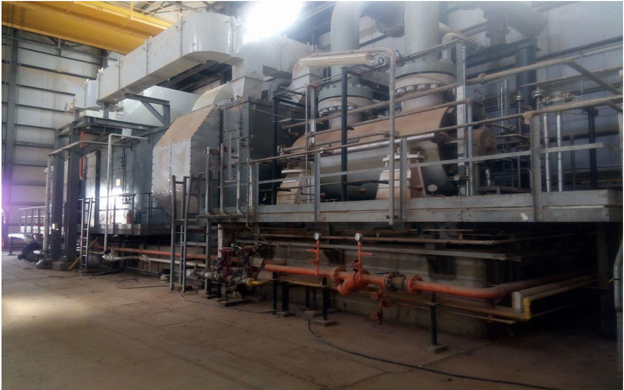
Figure.III.27.Turbine à gaz MS 5002C et compresseur centrifuge BCL606-3/A.
