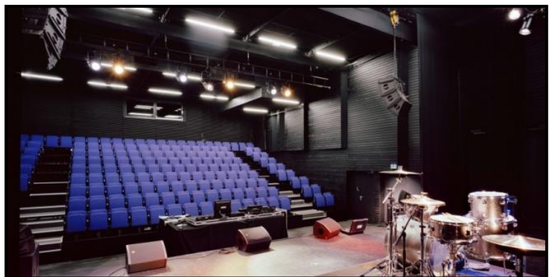
figure 168: éclairage artificiel dans une salle de spectacle
