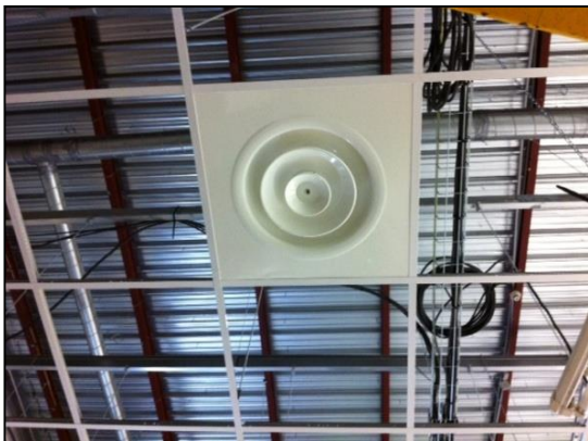
figure 171:: Bouches de Soufflage
