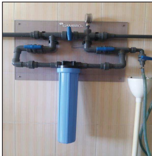
Photo.7: Filtre à cartouche de la station d'EPH [Source :Sarra&Khadidja]
