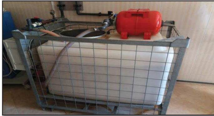
Photo.3: Réservoir d'alimentation de la station de l'EPH [Source :Sarra&Khadidja]
