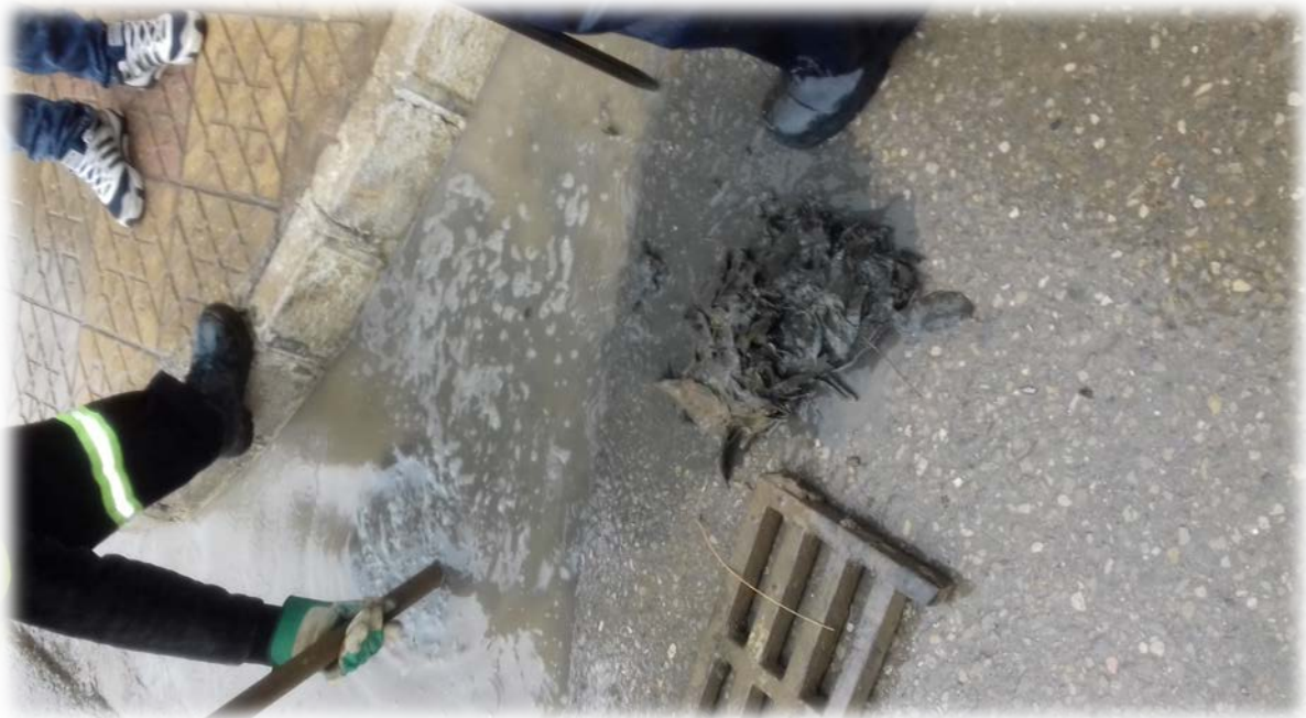
Figure III.4 : Colmatage d'un avaloir (Centre de Bensekrane).
