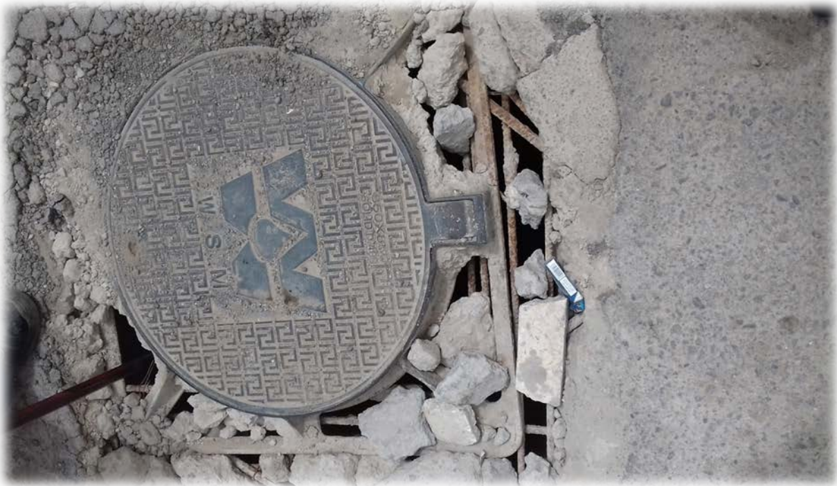
Figure III.37 : Désagrégation du béton.
