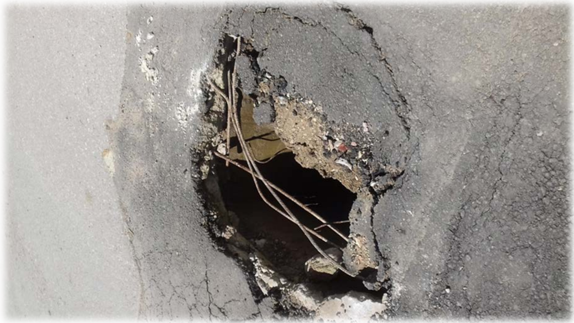
Figure III.34 : Regard invisible avec le problème des travaux des routes.
