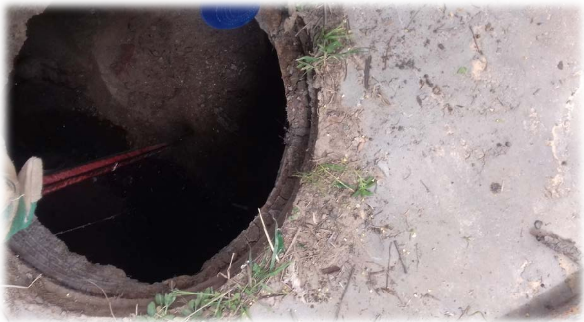
Figure III.22 : Un regard sec plein de débris de 1,3m de profondeur ( Dechra1).
