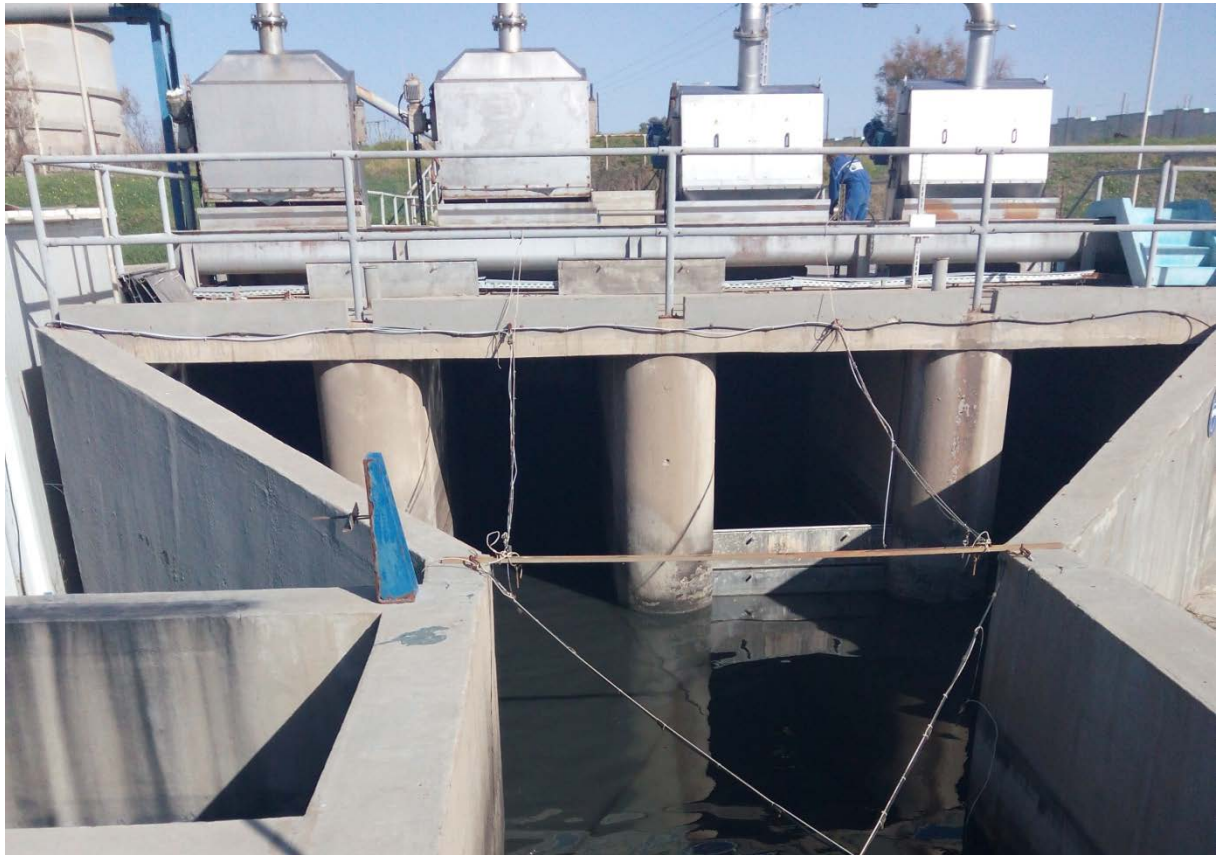
Figure II.4 : Les 4 dégrilleurs fins mécaniques.
