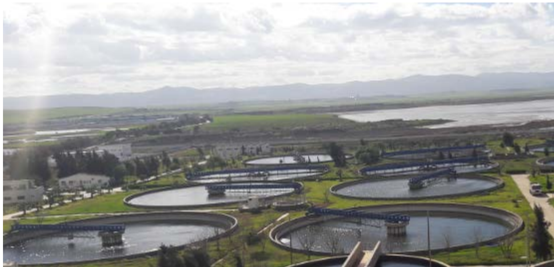
Figure II.6 : Les 4 décanteurs primaires
