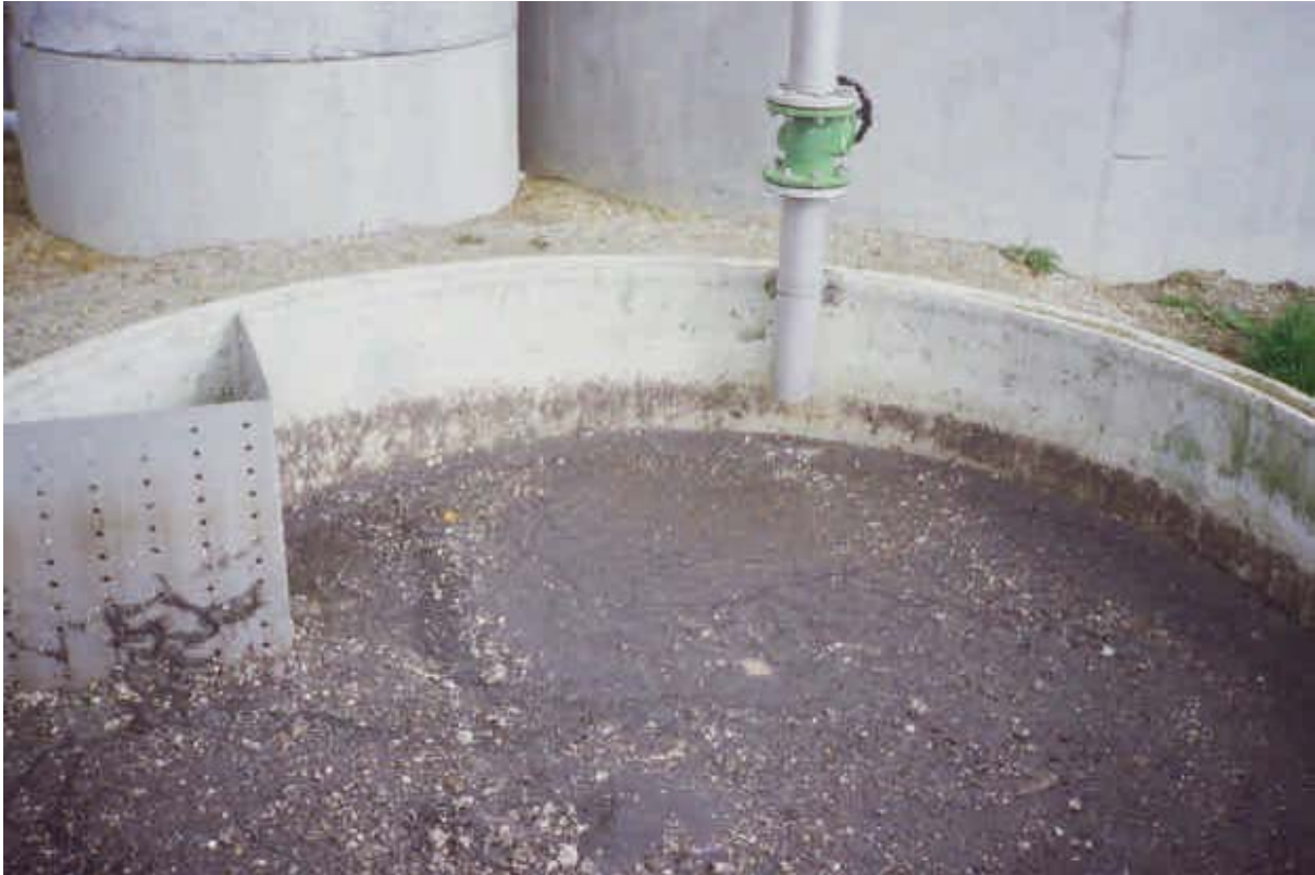
Figure I.1: Extraction du sable d'un déssableur-dégraisseur [4]
