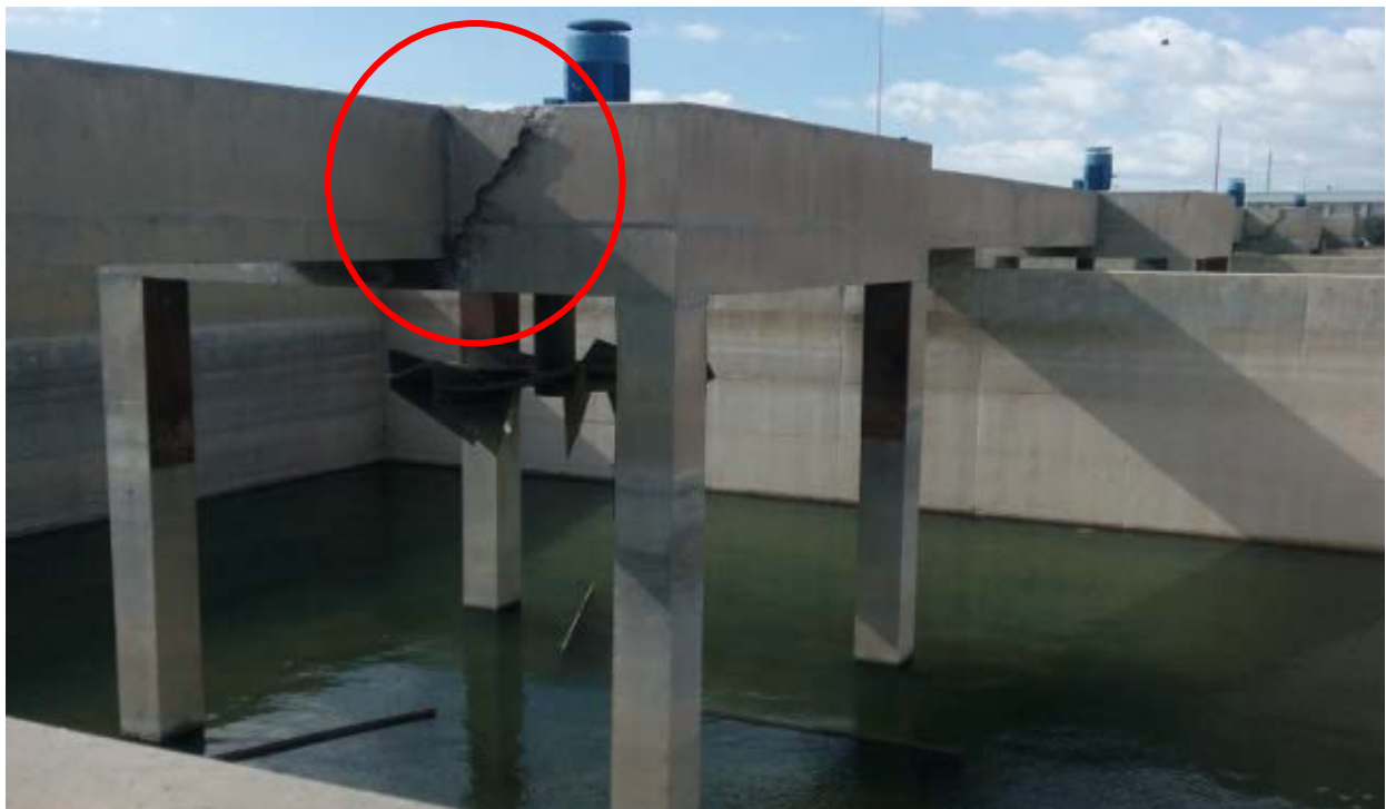
Figure III.22 : La fracturation dans le bassin d'aération
