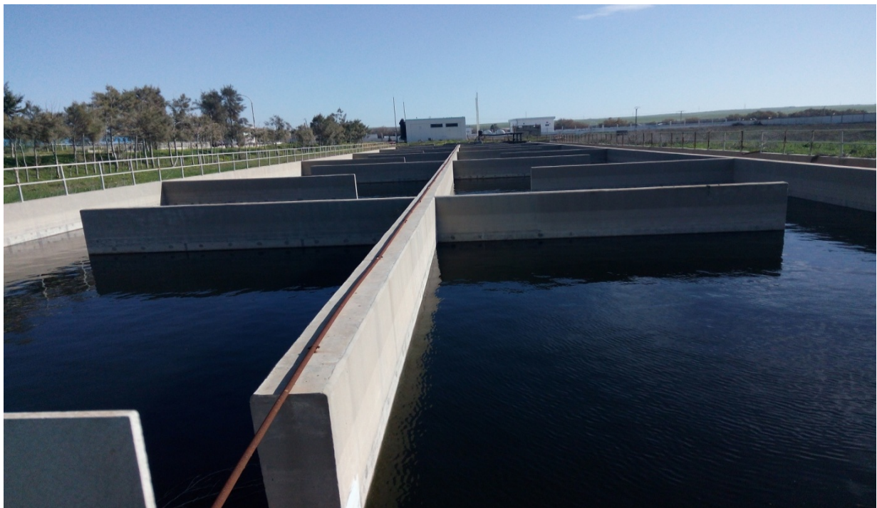
Figure II.10 : Bassin de désinfection.
