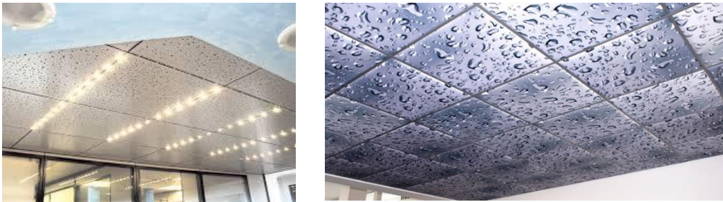
Figure 218 : faux plafond en aluminium
