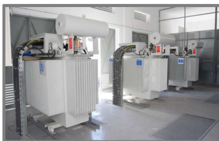
Figure 220: Le poste de transformateur.
