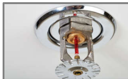
Figure 223: Extincteur automatique à eau.
