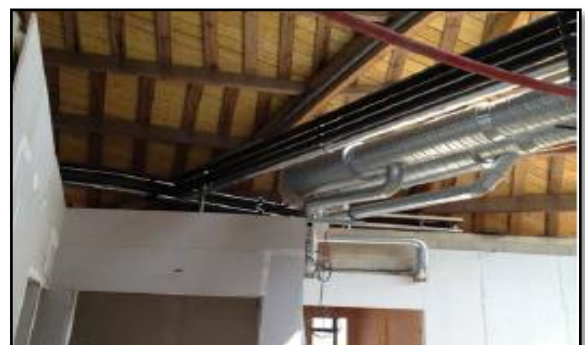
Figure 30 : système de ventilation
