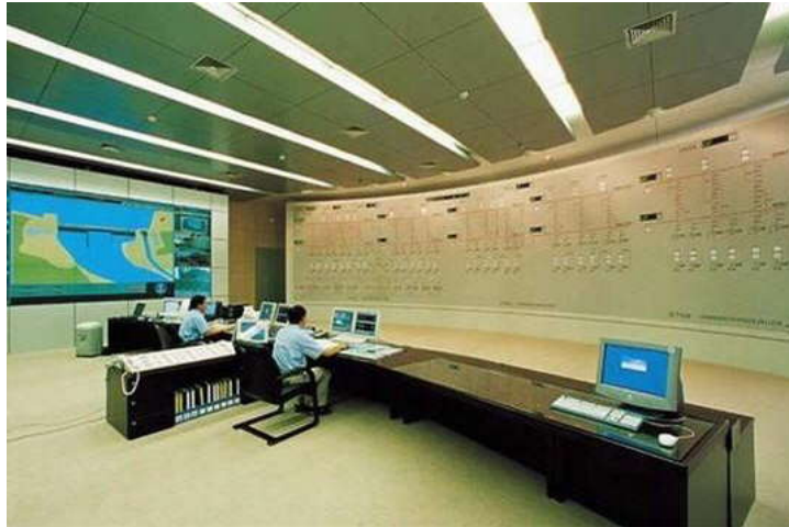
Fig. I.6: Salle de contrôle
