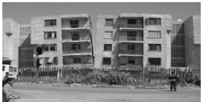
Figure IX.4 : Ouverture entre deux bâtiments (Boumerdes, 2003)
