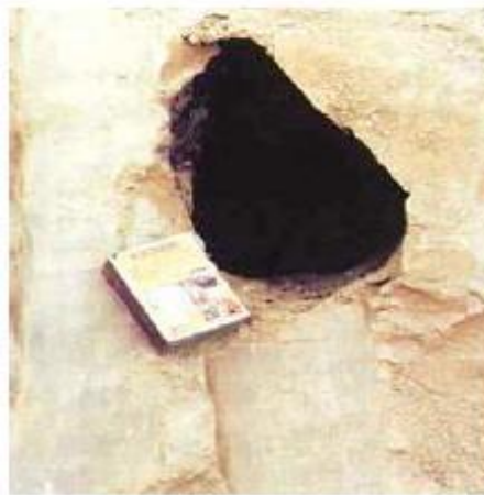
Figure 5.3 : Phénomène de débouillage au barrage de Lafage (Lautrin, 2002)
