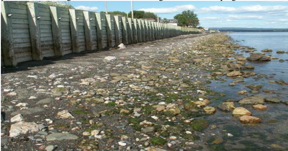
Figure 5.16 : Abaissement de la plage causé par un mur de soutènement (Maria, Gaspésie).
