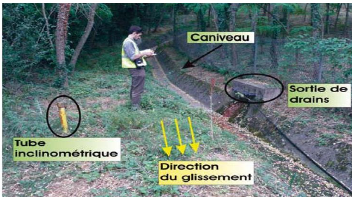
Figure 4.8 : drainage des eaux de surface à l'aide d'un caniveau.
