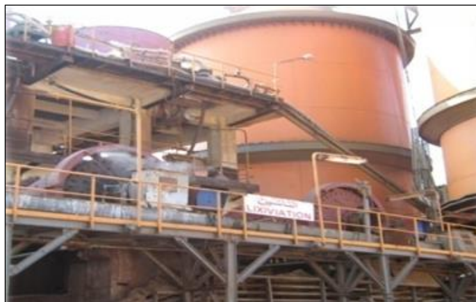
Figure1.4: Vue de l'atelier lixiviation.
