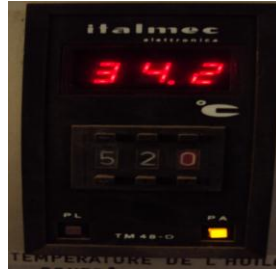
Figure 2.14. L'indicateur de température de fonctionnement
