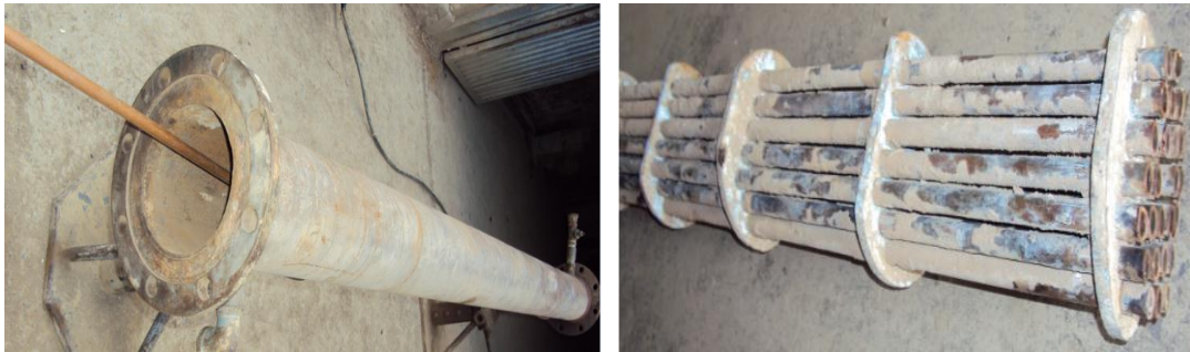
Figure 3.9. Bouchage de l'échangeur de chaleur
