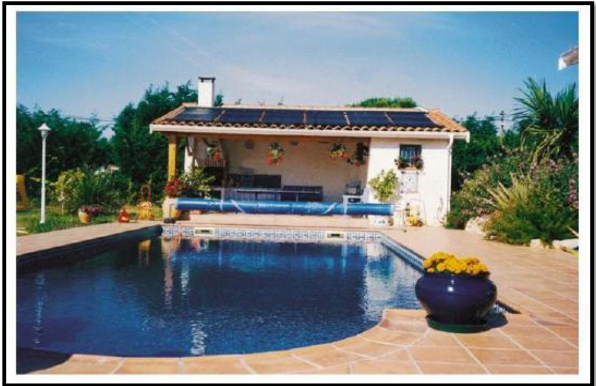
Fig II.2: Photo représentant le chauffage d'une piscine par un capteur sans vitrage
