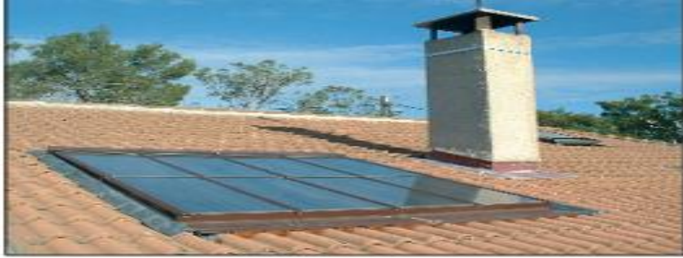
Figure (II.13) capteurs plan intégré en toiture [21]
