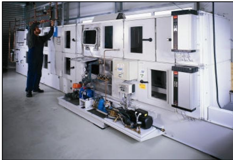
Figure II. 14: Exemple d'une unité de traitement d'air à dessiccation avec une roue déshydratante (débit d'air nominale est de 4500 m 3 /h).
