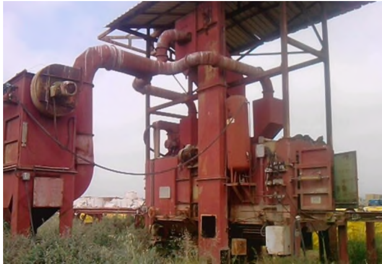
Figure I.3 : grenailleuse automatique COGEIM (STT)
