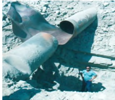
Figure II.3 : Eclatements avec rupture franche de la canalisation [20]
