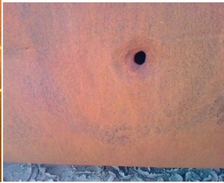
b- pique de corrosion
