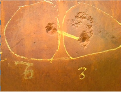
a- Pics de corrosion (localisée)
