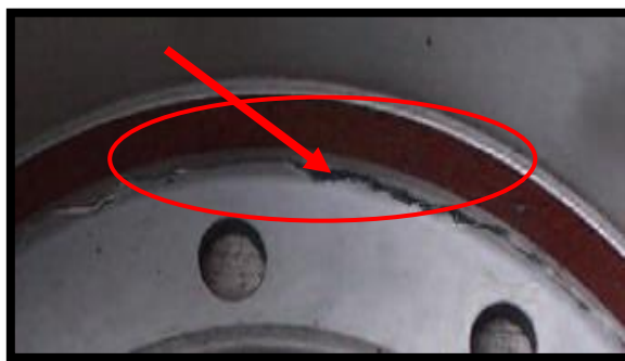
Figure 3.18 : Fissures apparaissent dans le cercle de boulonnage [15].
