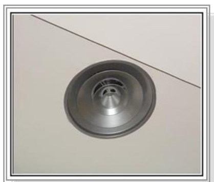
Bouches de Soufflage
