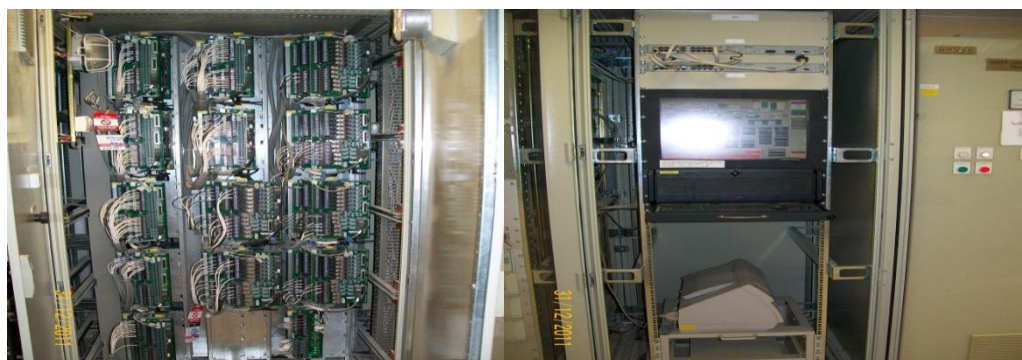
Fig.2.24.l'armoire d'alimentation et le HMI [3]
