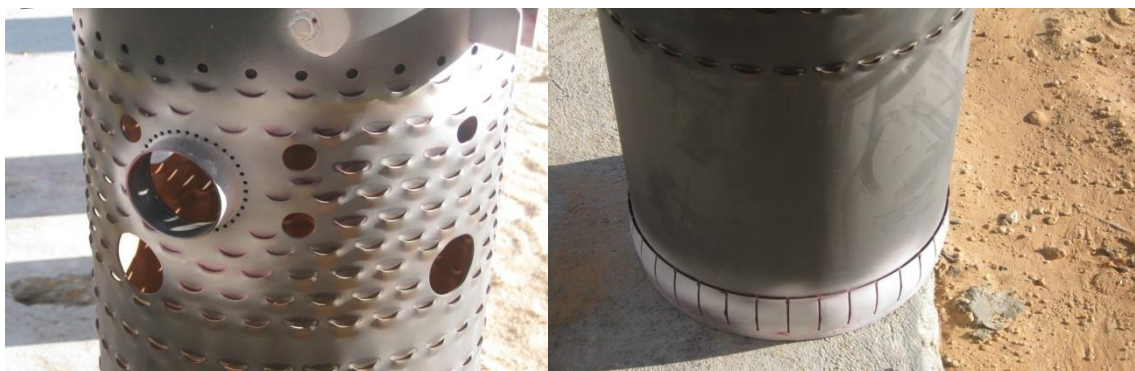
Fig.2.40.résultat de l'inspection sur les tubes à flammes [3]
