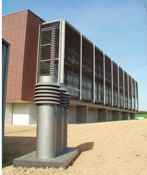
Figure III.16: Cheminées d'entrées d'air d'un puits Canadien
