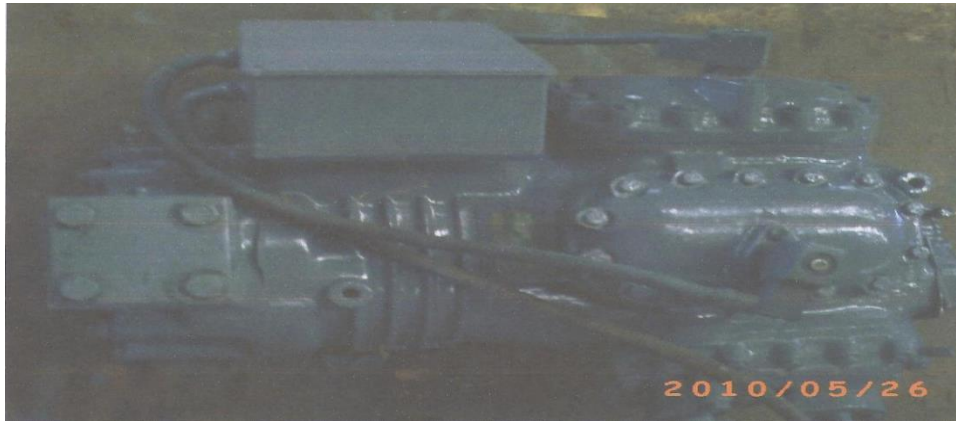
Figure IV.5 : Le compresseur de l'installation [26].
