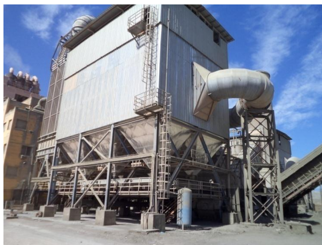
Figure 1.16: filtre à manche
