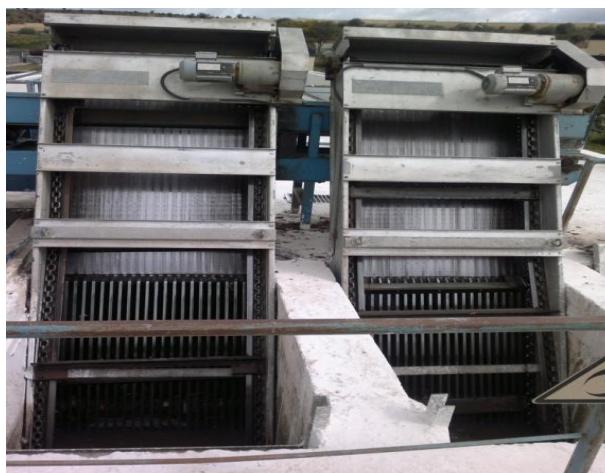
Fig. III.5 : Grille mécanisée (deux unités).
