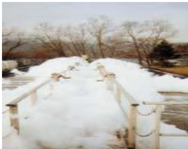
Fig. III.28 : Mousse blanche de démarrage en surface de bassin d'aération [41].
