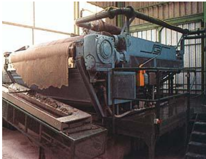
Fig. II.7 : Déshydratation des boues par filtre à bande [28].
