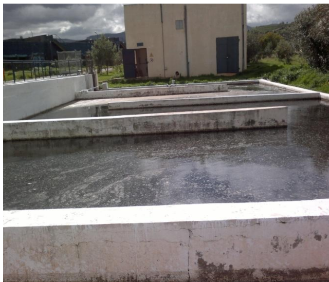
Fig. III.12 : Bassin de chloration.
