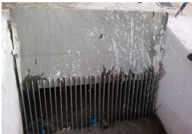
Fig. III.4 : Grille grossière manuelle (1unité).
