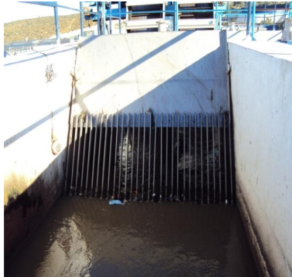
Fig. I.1 : Dégrillage droite (incliné de 70%)
