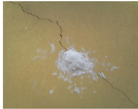
Figure 3.8 : Plaque témoin sur une fissure en diagonal.
