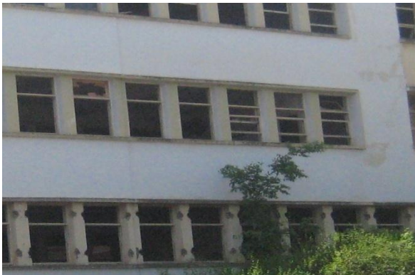
Figure 4.4 : Menuiseries en mauvais état.
