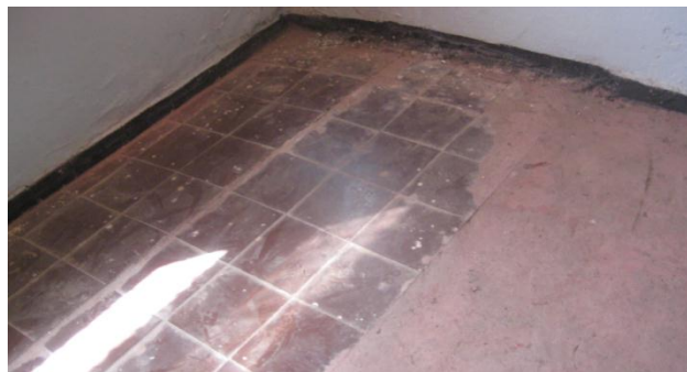
Figure 6.2 : Exemple de carrelage endommagé (partie 3, 1 er étage).
