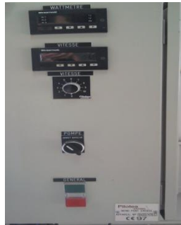
Fig.4.5: Armoire de commande [21].
