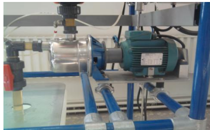
Fig.4.3:Pompe et moteur [21].
