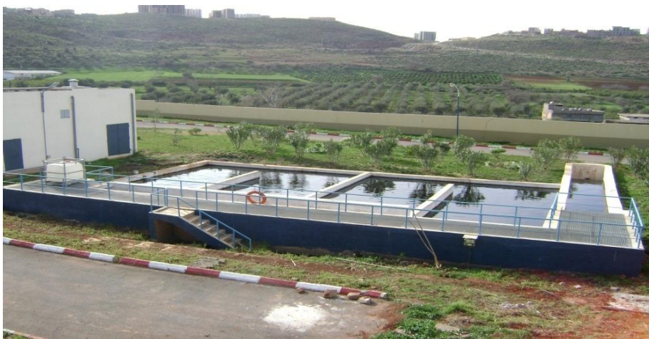
Figure.II.9. : Bassin de chloration.
