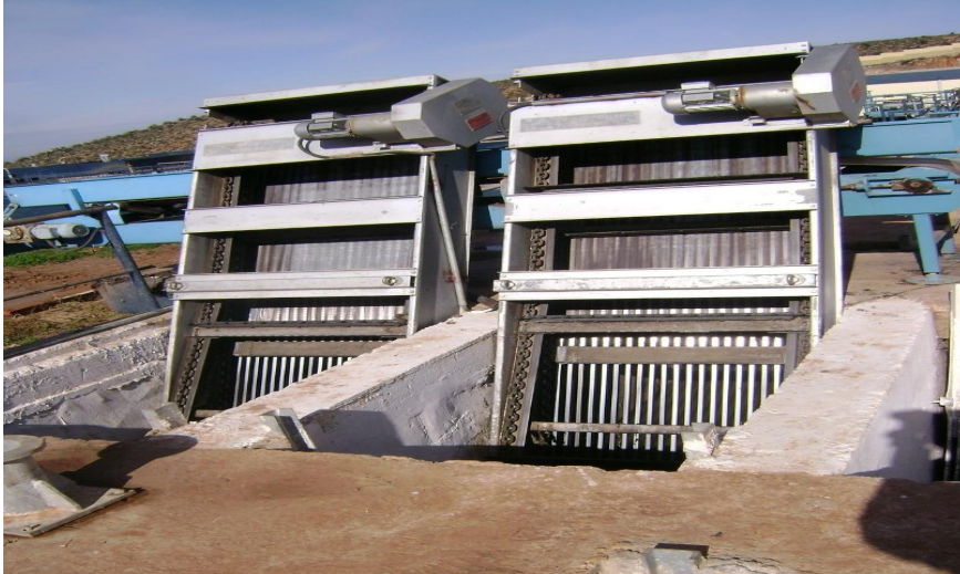
Figure. II.4. Grille mécanisée (deux unités)
