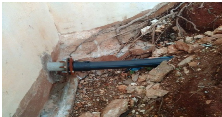
Fig.2.7 Conduite en PEHD 110
