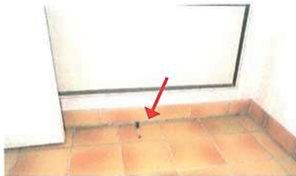
Figure 1.6 : Affaissement du plancher mis en évidence par le décollement entre plinthes et dallage - Maison Jourdan.
