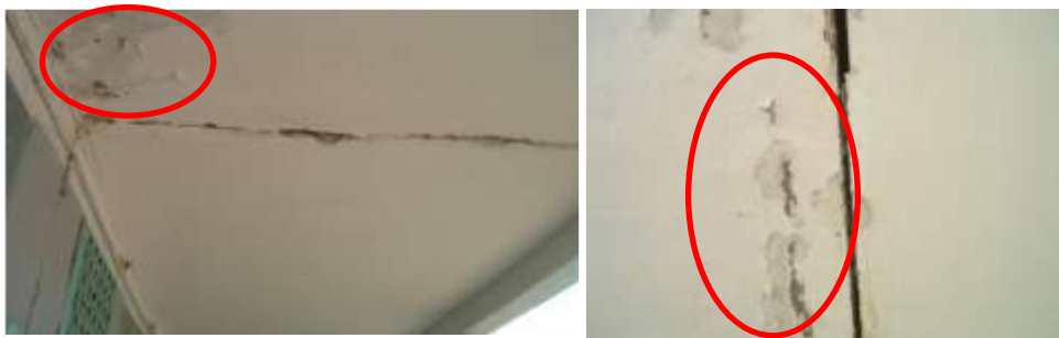
Figure 3.18 : Les infiltrations d'eau au niveau des ouvertures des joints.
