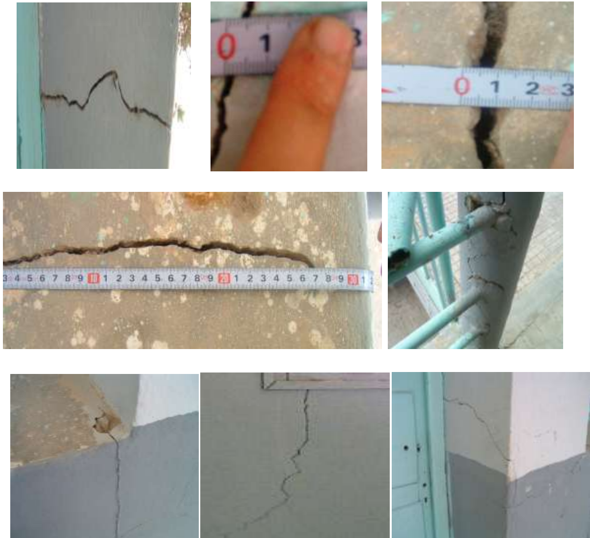
Figure 2.12 : Les différentes fissures (horizontale,verticale,inclinée) dans le CEM.
