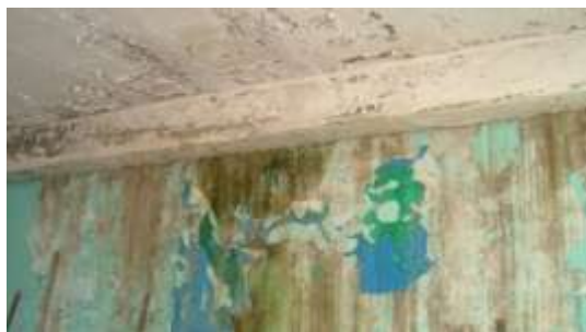
Figure 3.19 : Présence d'humidité à l'intérieure des classe par l'eau de pluies.
