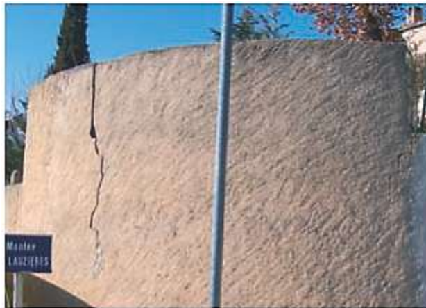
Figure 1.11: Désordres affectant un mur de soutènement.
