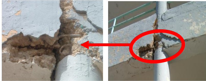
Figure 4.8 : Armatures corrodées au niveau de l'ouverture du joint de dilatation.
