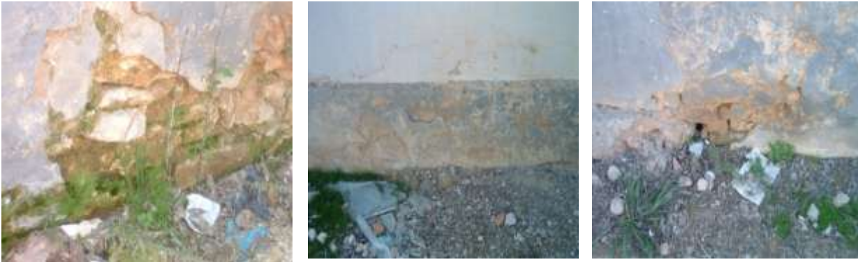
Figure 3.16 : Absence de trottoirs périphérique à l'extérieur du Cem.
