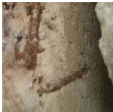
Figure 2.17 : Carbonatation au niveau de l'ouverture du joint de dilatation.
