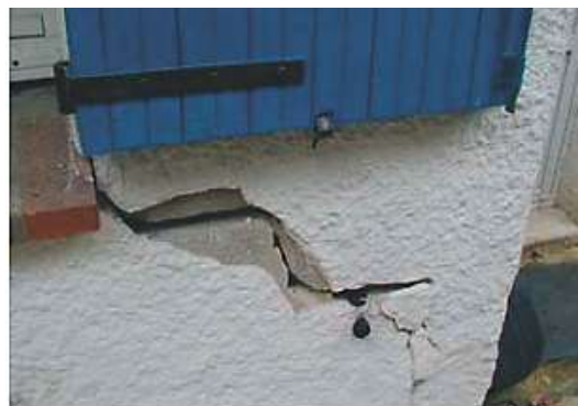
Figure 1.7 : Désordres affectant une fenêtre.
