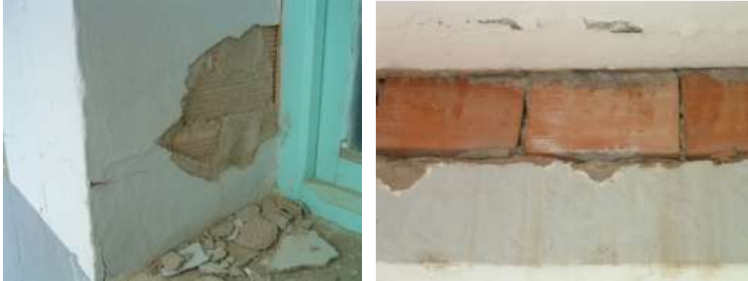
Figure 2.19 : Détachement des enduits et de mortier sur quelques endroits des parois extérieur des classes.
