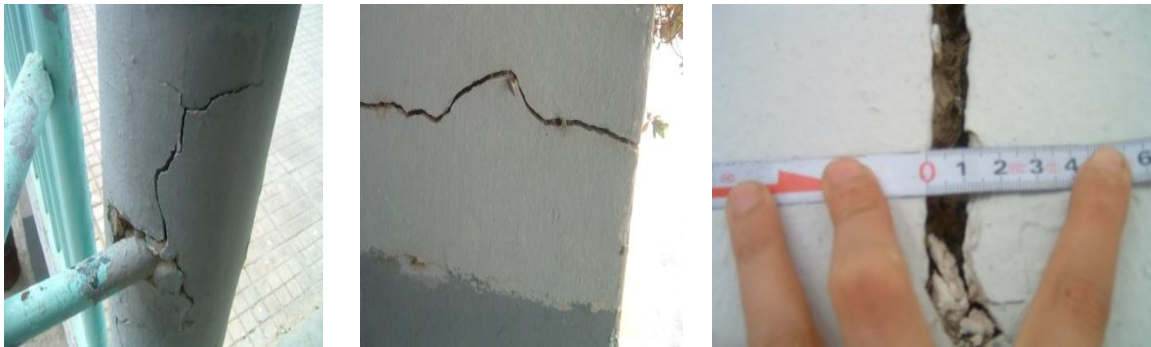
Figure 4.10 : Les différentes fissures dans le bloc.
