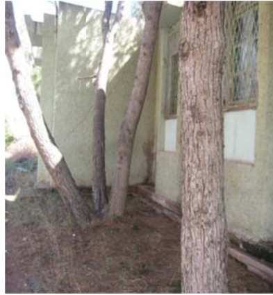
Photo II -9: Présence de plantations et végétations aux alentours du bâtiment.
