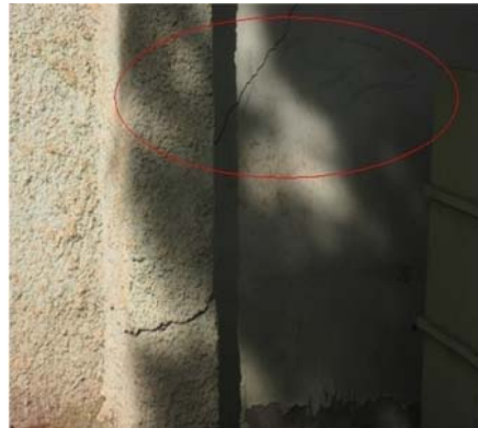
Photo II-7: Fissuration diagonale profonde dans les façades.
