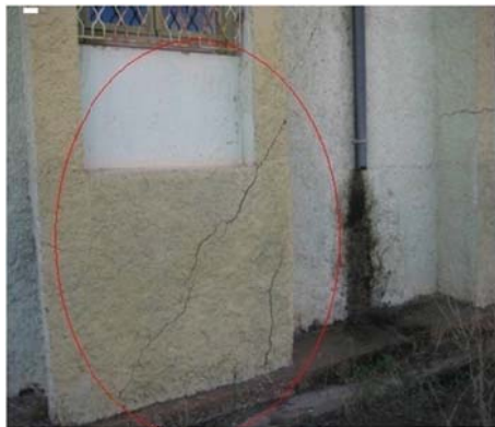
Photo II-6: Fissuration diagonale superficielle dans les façades
