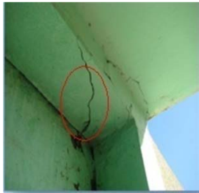
Photo II -3 : Eclatement du béton.
