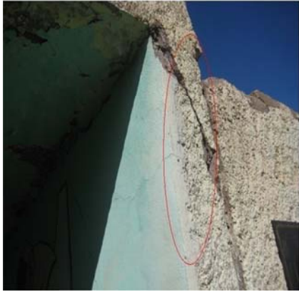
Photo II-8: Fissures très importantes inclinées en tête des poteaux.
