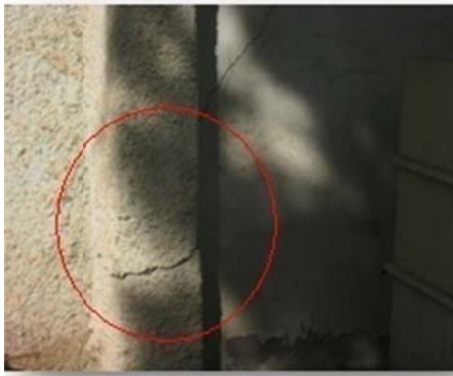
Photo II-2 : Fissuration diagonale dans les murs extérieurs.
