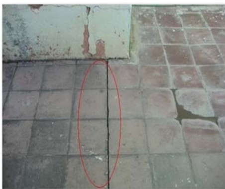
Photo II-4: Affaissement et fissuration du dallage par endroit.
