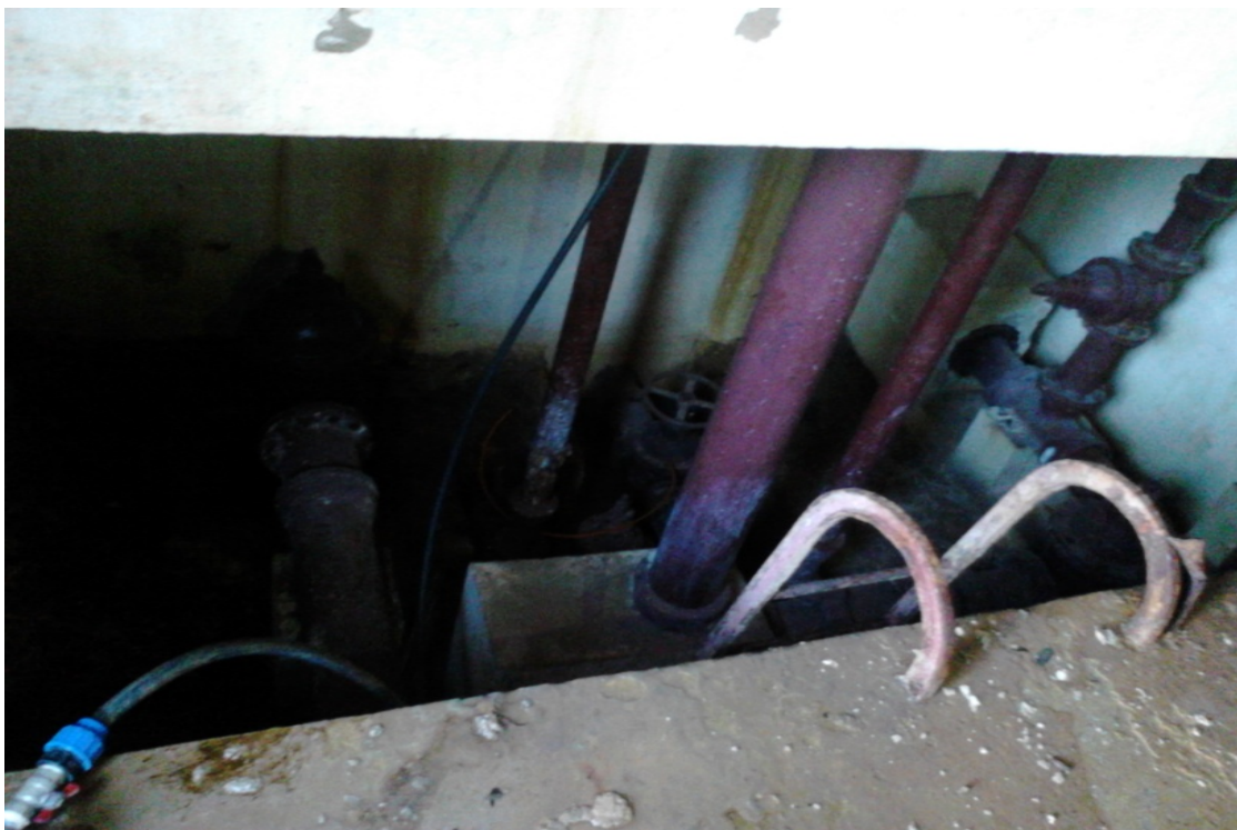
Figure II.5 : la chambre de vannes
