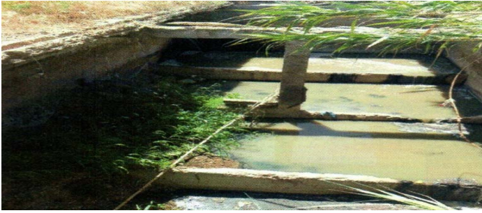
Figure I.26. : RjT1, bassin de décantation défectueux (HPO)
