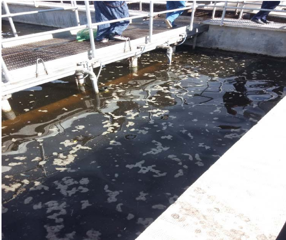
Figure III. 5 : photo du clarificateur
