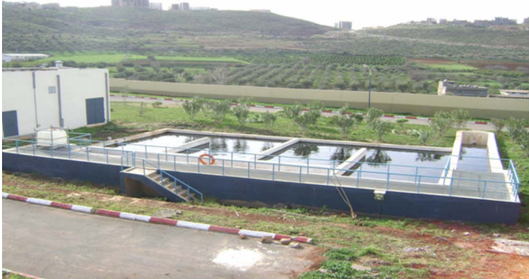
Figure III. 15 : photo du bassin de chloration
