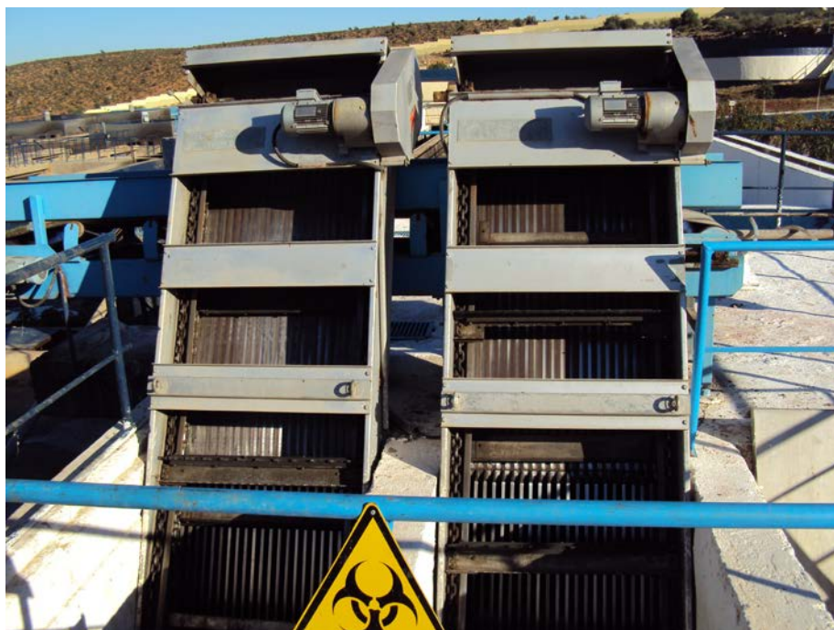
Figure III. 11 : photo des grilles mécanisées (2 unités)
