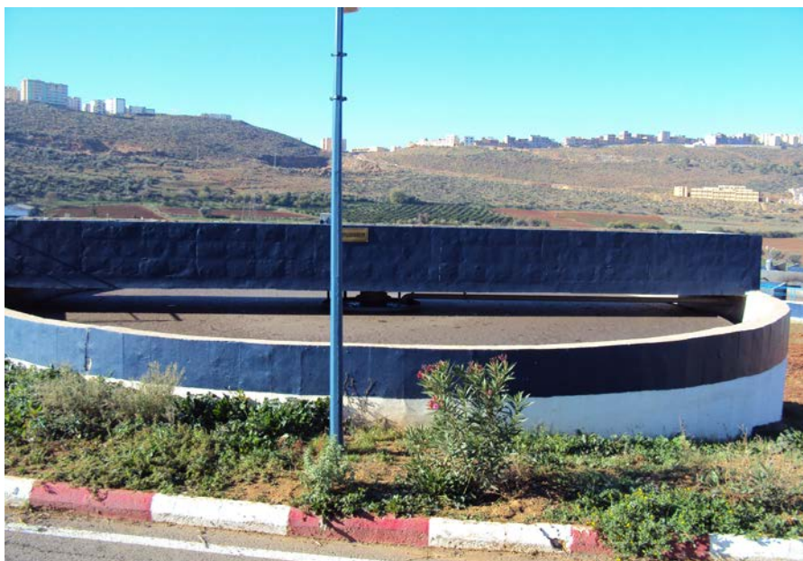
Figure III. 16: photo de l'épaississeur
