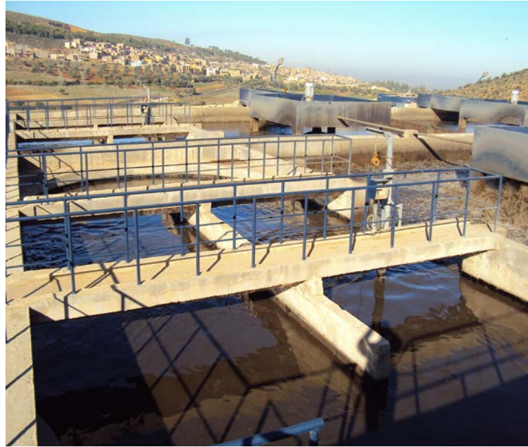
Figure III. 13: photo de bassins d'aérations
