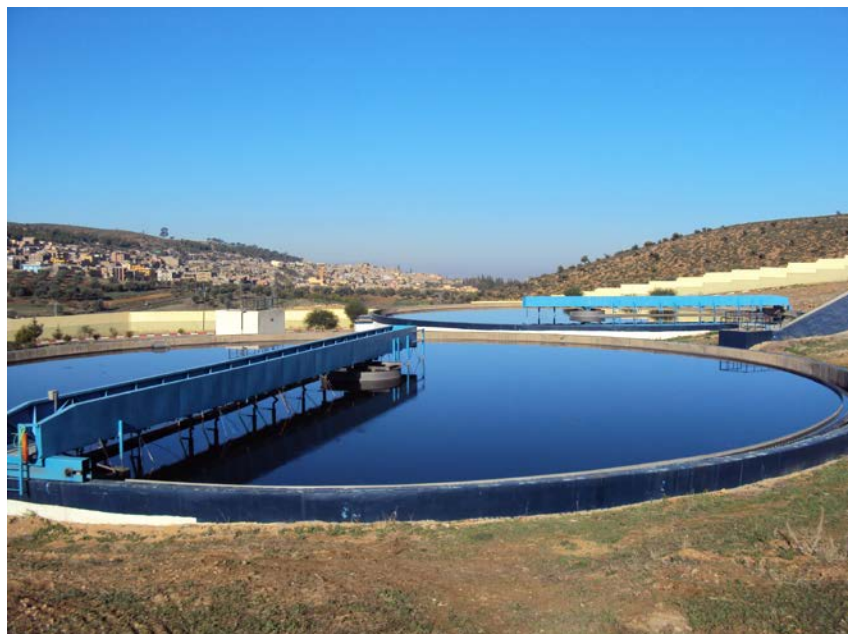
Figure III. 14: photo du décanteur secondaire
