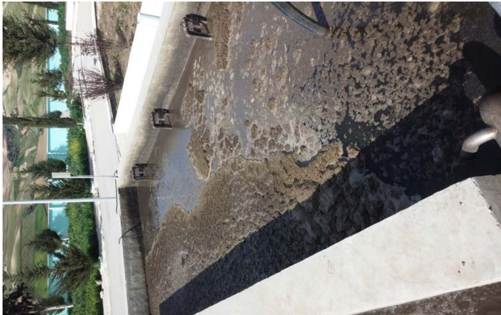
Figure III. 6 : photo de digesteur de boue
