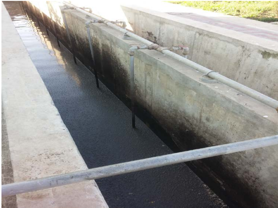
Figure III. 3 : photo du bassin sélecteur d'homogénéisation
