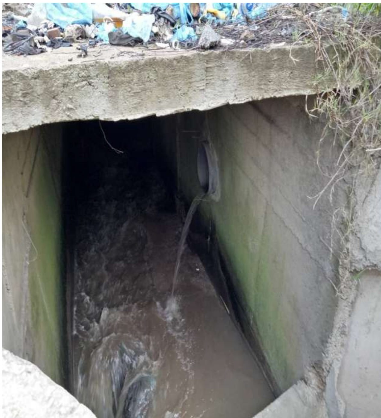
Figure III.5 : Déversoir d'orage (Feddan Sbaa)
