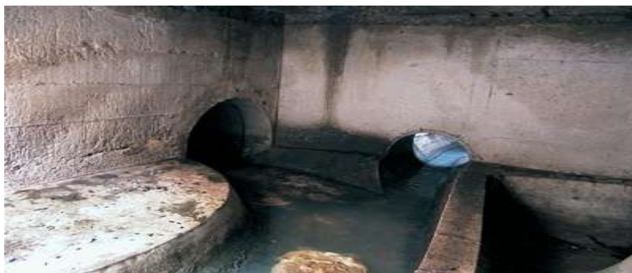
Figure I.11 : Un déversoir d'orage [15]
