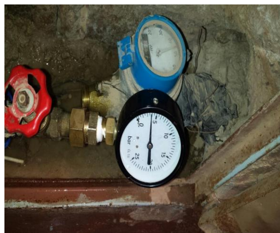
Figure V. 9 : Raccord du manomètre avec la conduite d'arrivée d'eau
