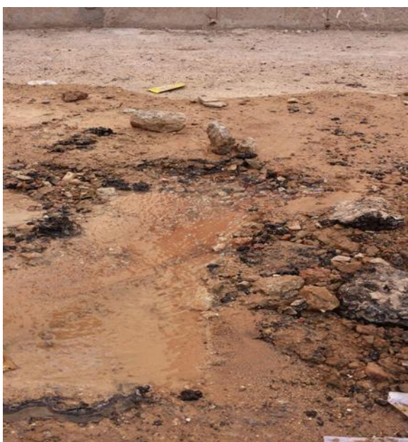
Figure V. 19 : Fuite d'eau Bd belkaid Ghouti (situé à environ 200 m du point 12)
