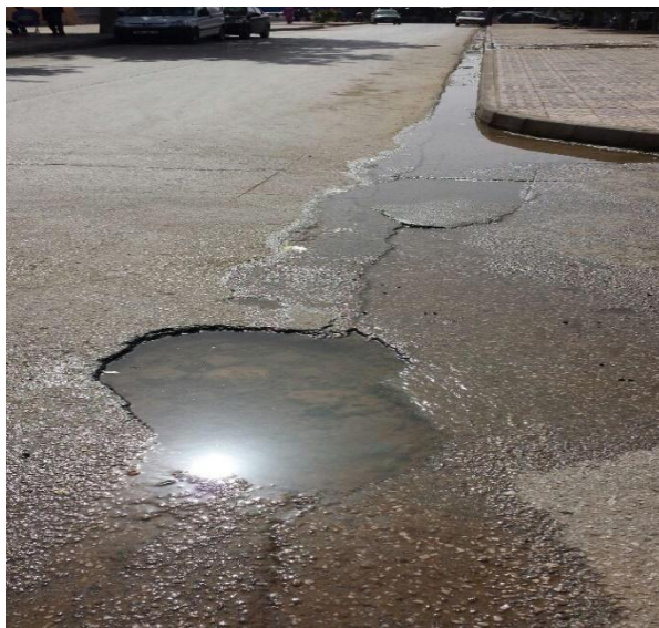
Figure V. 16 : Fuite d'eau (bd Allem Mouloud) environ à 200 m du point 7)
